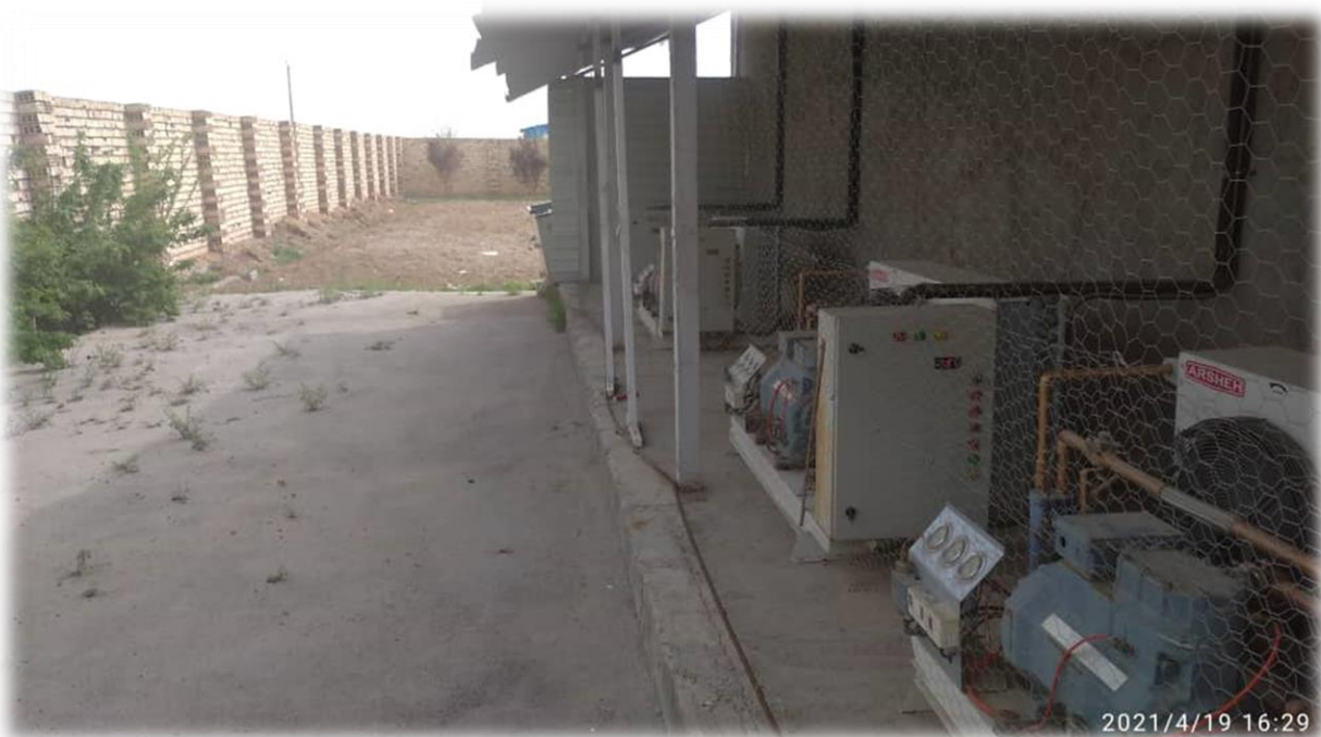
نمایه ۷: نمایی از تاسیسات سردخانه‌های شرکت
